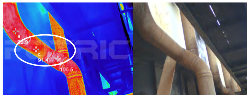
正常的顶循管道
